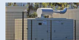
非常用発電機
