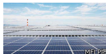
太陽光パネル
