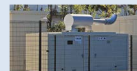
非常用発電機
