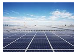
太陽光パネル
