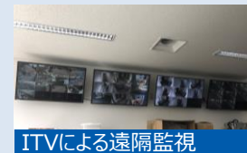
ITVによる遠隔監視
