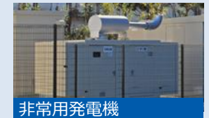
非常用発電機
