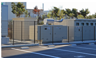
非常用発電機
