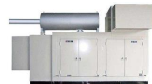
非常用発電設備
